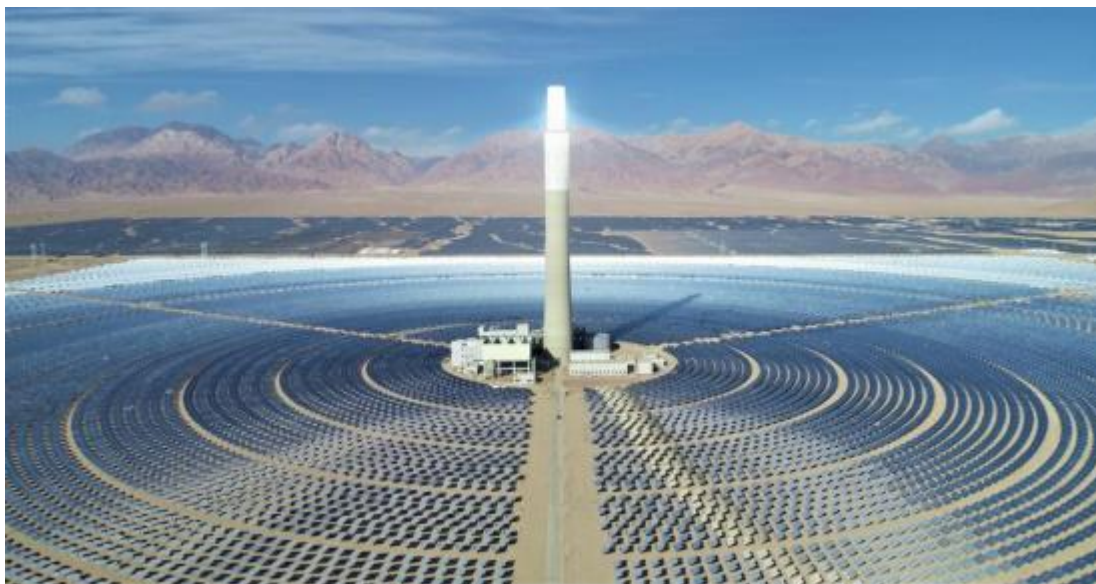
青海中控德令哈 50MW 光热电站
