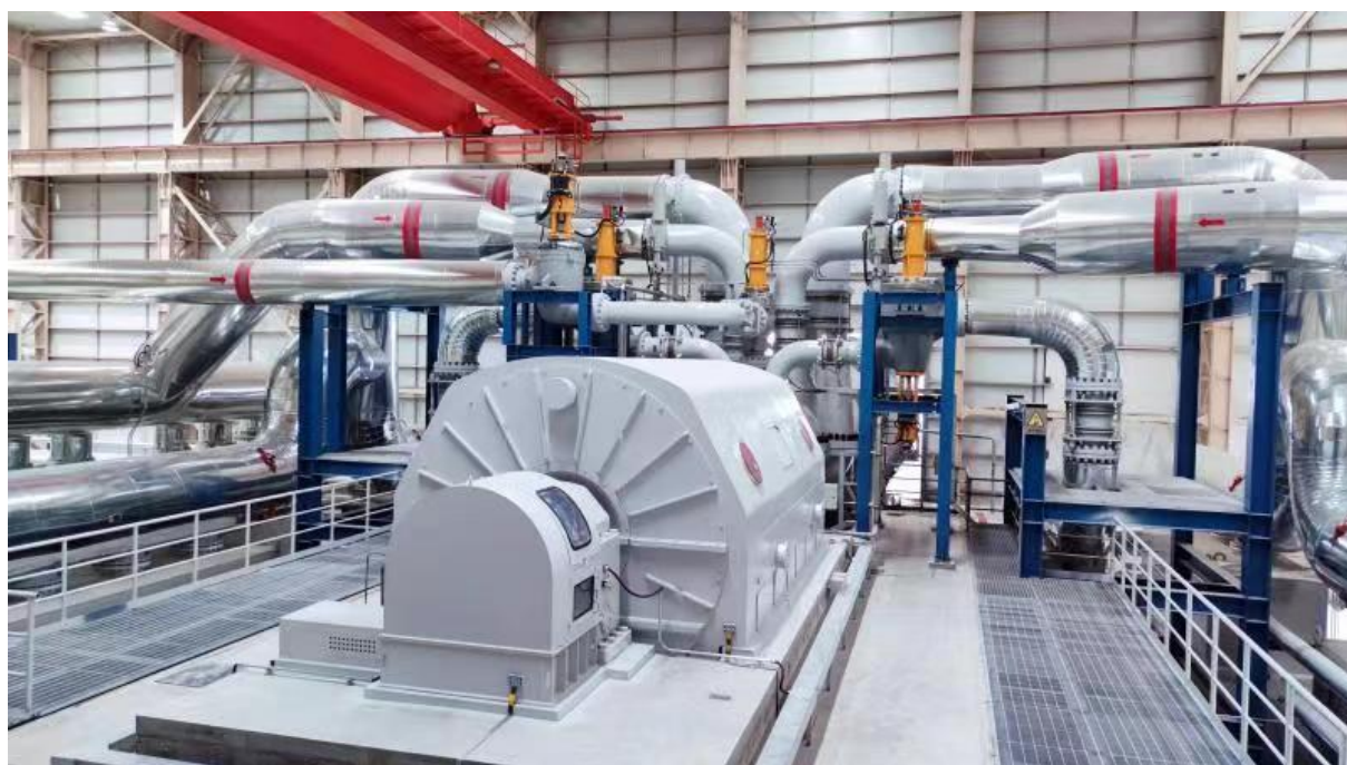
国际首套百兆瓦先进压缩空气储能系统膨胀机组
