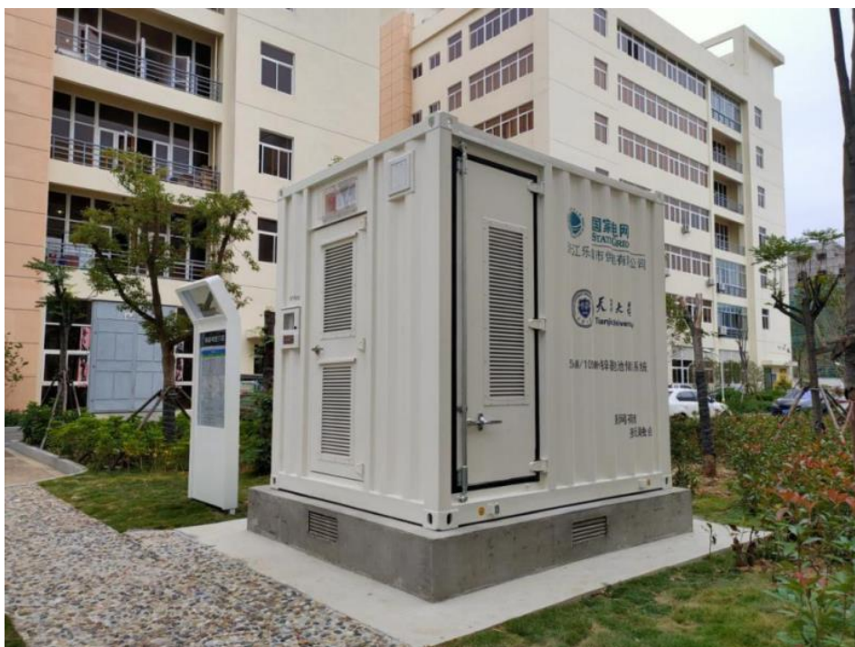
50 千瓦/105 千瓦时锌基电池储能系统外观
